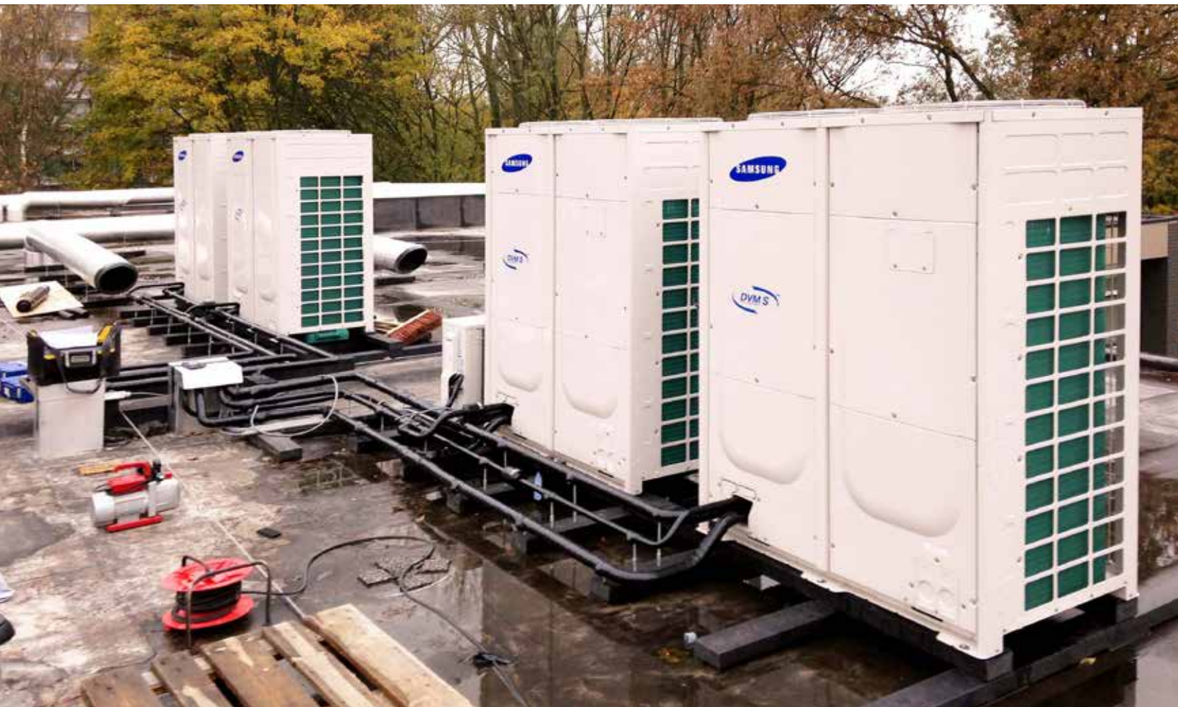
Het Samsung DMV S warmtepompsysteem is 'all-electric' uitgevoerd.
