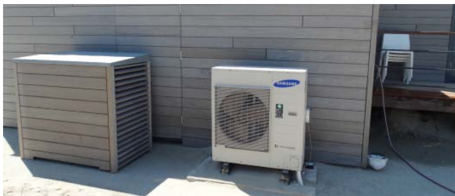
De houten omkasting, met daarnaast de buitenunit die normaal onzichtbaar is.
