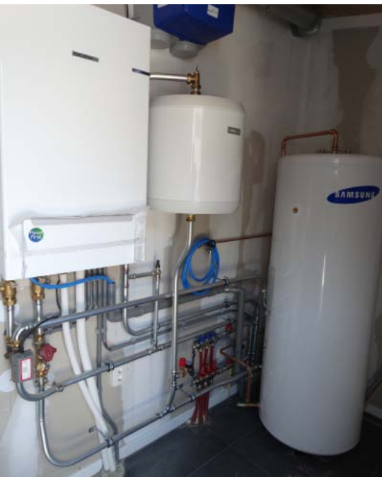
De technische ruimte van een hotelsuite, met de warmtepomp, een doorstroomvat voor de vloerverwarming en een buffervat voor warmtapwater.
